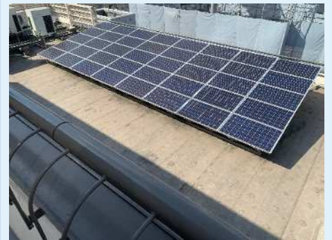
<本社ビル太陽光発電>
